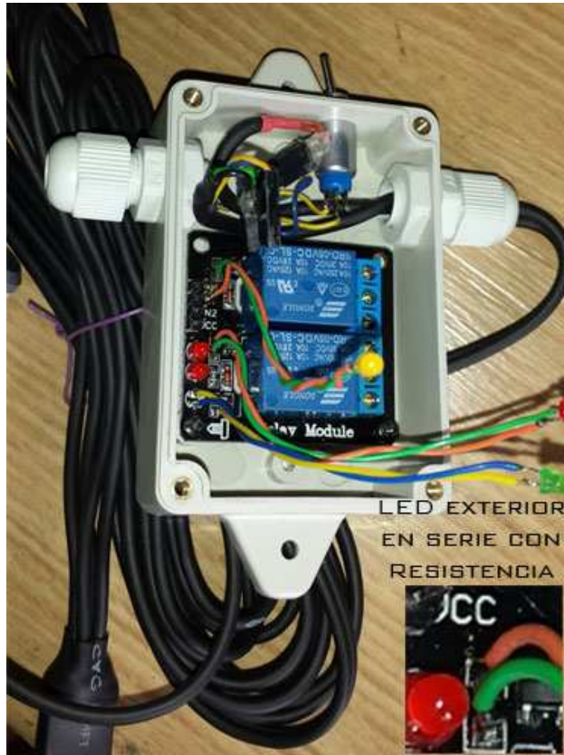
Interior de la caja de relés.
